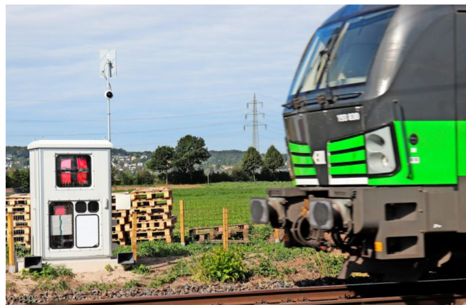
Wacht am Gleis: Kamera- und Sensortechnik überprüft den technischen Zustand der Güterzüge im Vorbeifahren. Foto Railwatch
